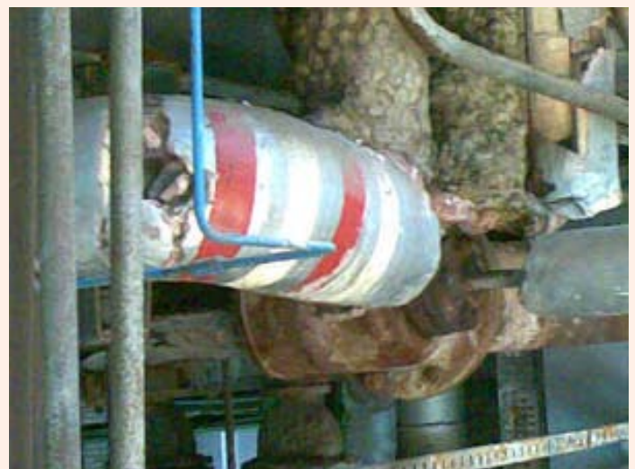
Tuberías en la zona de calentadores del Grupo Vapor 1
