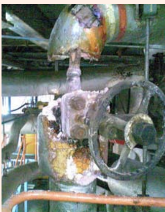
Válvula raíz vapor eyectores del Grupo Vapor 1
