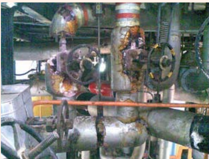
Válvulas raíz vapor de cierre y vapor eyector del Grupo Vapor 1
